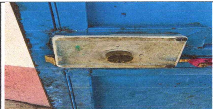
Foto 5: Sustrucción de chapa
